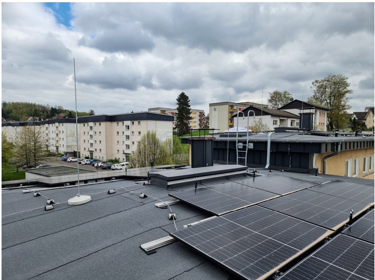
PV-Anlage Breslauer Str. 32
